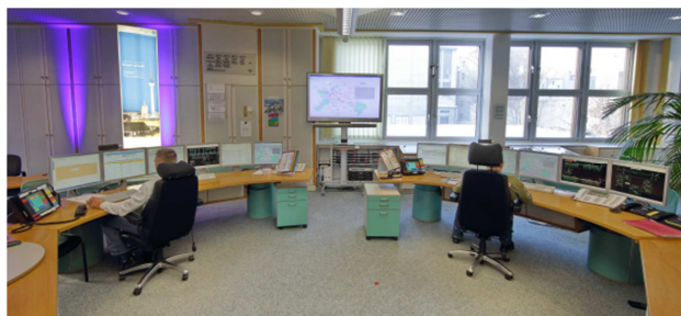
Foto: Blick in die Mittelspannungswarte
