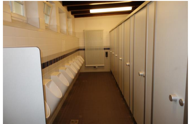
Nicht historisch, sondern hochmodern und vorzeigewert: Der Sanitärbereich der Schule. Foto: Ed Koch
