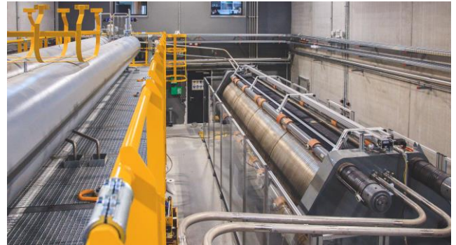
Die Anlagen von Sunfire helfen Unternehmen in der Energie-, Stahl- und Chemieindustrie dabei, CO 2 -neutral zu werden.
